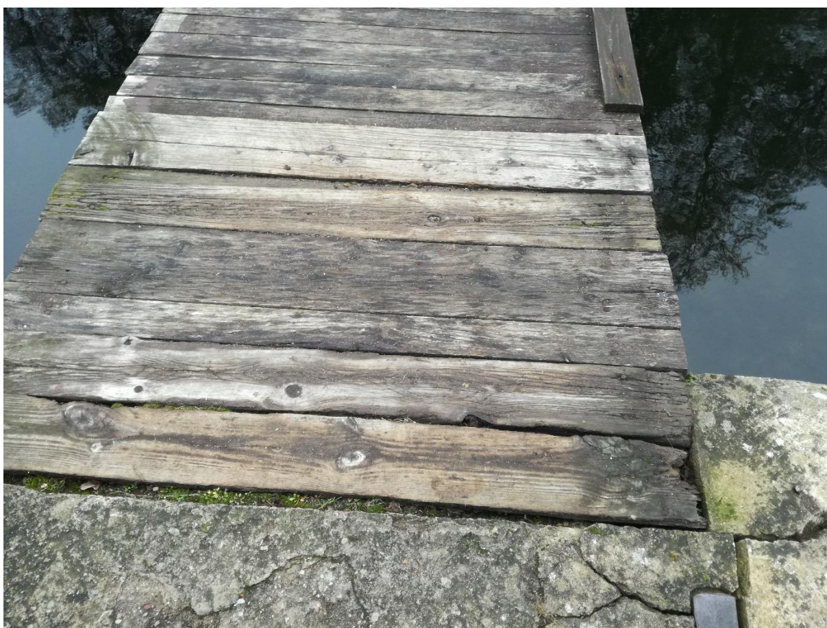
Drewniana nawierzchnia pomostu z oznakami starzenia i gnicia materiału, ubytkami materiałowymi, z występującą korozją biologiczną.
