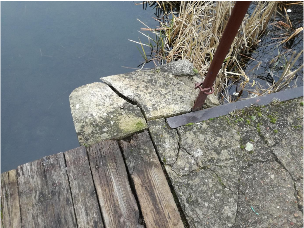
Filar kamiennieo-betonowy z ubytkami materiałowymi, pęknięciami.
