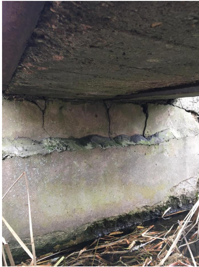
Intensywne pęknięcie filara.
