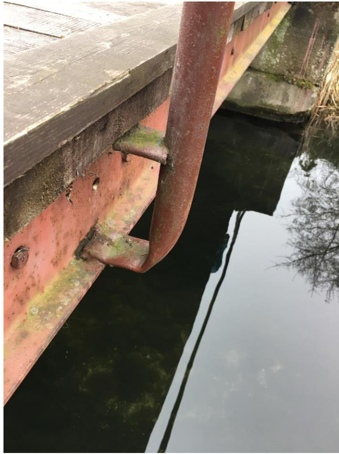
Korozja biologiczna i korozja stali w miejscu mocowania balustrad.
