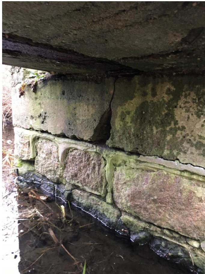
Przyczółek z pęknięciami, ubytkami materiałowymi, korozją biologiczną. Korozja skrajnych elementów stalowych pomostu.
