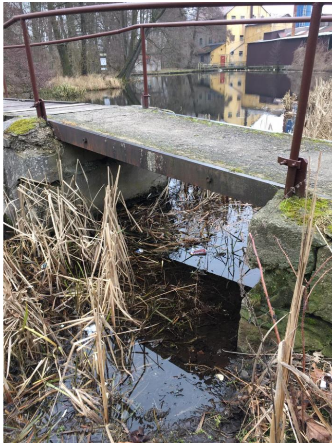
Widok nawierzchni betonowej kładki z licznymi pęknięciami, korozją biologiczną i wegetacją roślin, korozją stali skrajnych elementów stalowych. Zarośnięta przestrzeń podobiektowa. Przyczółek i filar kamiennieo-betonowy ze znacznymi ubytkami materiałowymi, pęknięciami. Deformacje balustrad.
