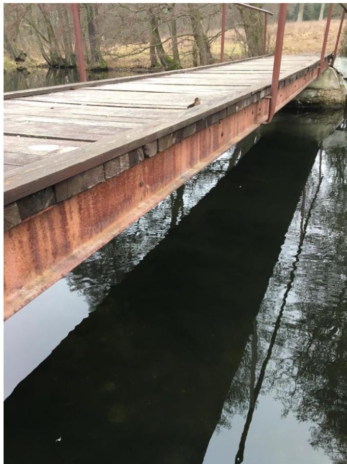
Przyczółek od strony kościoła z przemieszczeniami, ubytkami materiałowymi, pęknięciami, wymyciami przez rzekę. Korozja stalowej belki podłużnej, utrata stateczności belki.
