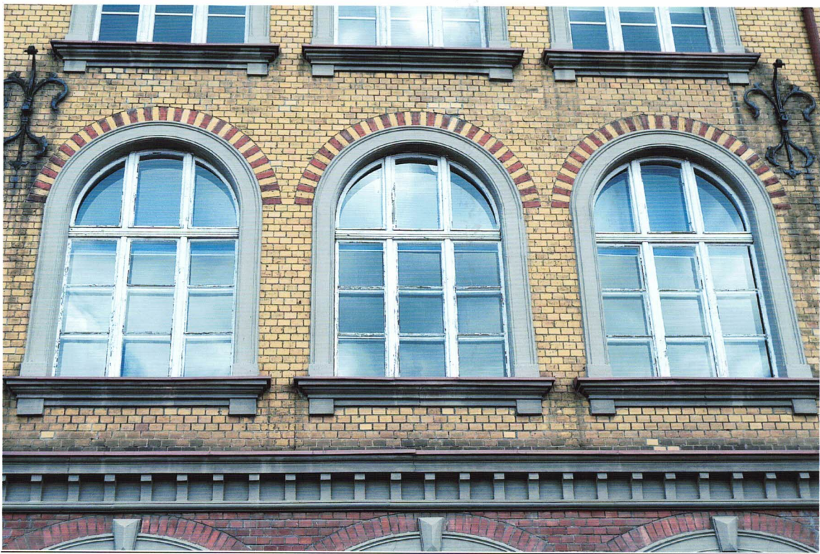
Fot. 8 Grudziądz, ul. Narutowicza 6 – Szkoła Podstawowa nr 3 im. J. Korczaka - okno TYP O/II – widok na awers okien znajdujących się w otworach okiennych I i II piętra Fot.. Ewa Bożejewicz 2021 r.
