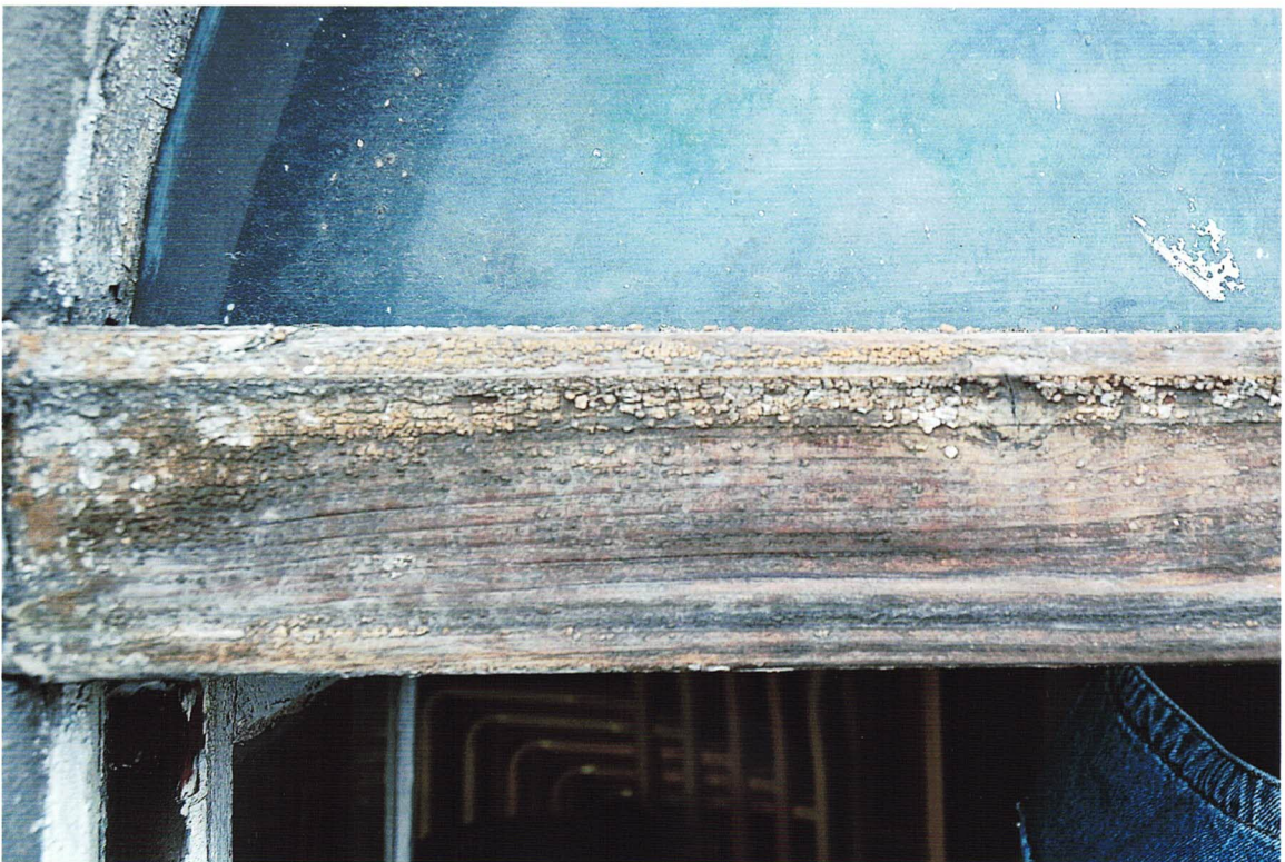
Fot. 21 Grudziądz, ul. Narutowicza 6 – Szkoła Podstawowa nr 3 im. J. Korczaka - widok na fragment śłemia pierwotnej stolarki okiennej
