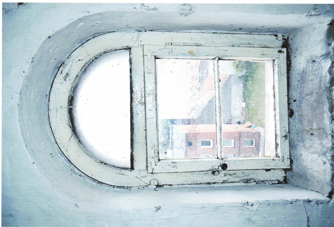
Fot. 19 Grudziądz, ul. Narutowicza 6 – Szkoła Podstawowa nr 3 im. J. Korczaka - widok na rewers pierwotnej stolarki okiennej zachowanej w ścinie kolankowej elewacji E Fot.. Ewa Bożejewicz 2021 r.
