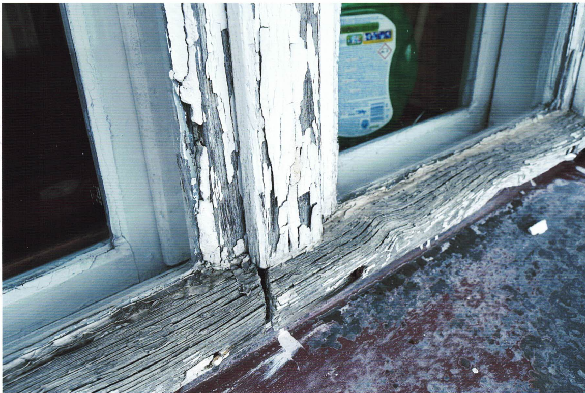
Fot. 17 Grudziądz, ul. Narutowicza 6 – Szkoła Podstawowa nr 3 im. J. Korczaka - okno TYP O/II – widok na stan zachowania stolarki okiennej
