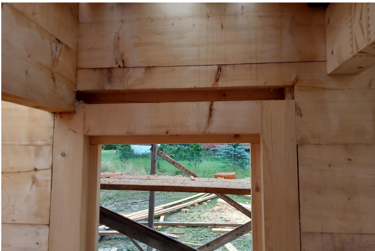
Fotografia nr 2 Pozostawienie przestrzeni na „zleg” (naturalne osiadanie konstrukcji drewnianej) przy zastosowaniu słupów wiązanych w otworze drzwiowym, widok od wnętrza budynku
