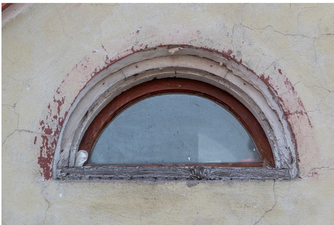
Fot. 29. Okno po lewej stronie na piętrze elewacji frontowej. Ościeżnica jest najprawdopodobniej starsza niż pozostałe okna. Niewykluczone, że zewnętrzne, niezachowane skrzydło okna podzielone było szczeblinami w dekoracyjnym, promienistym układzie.
