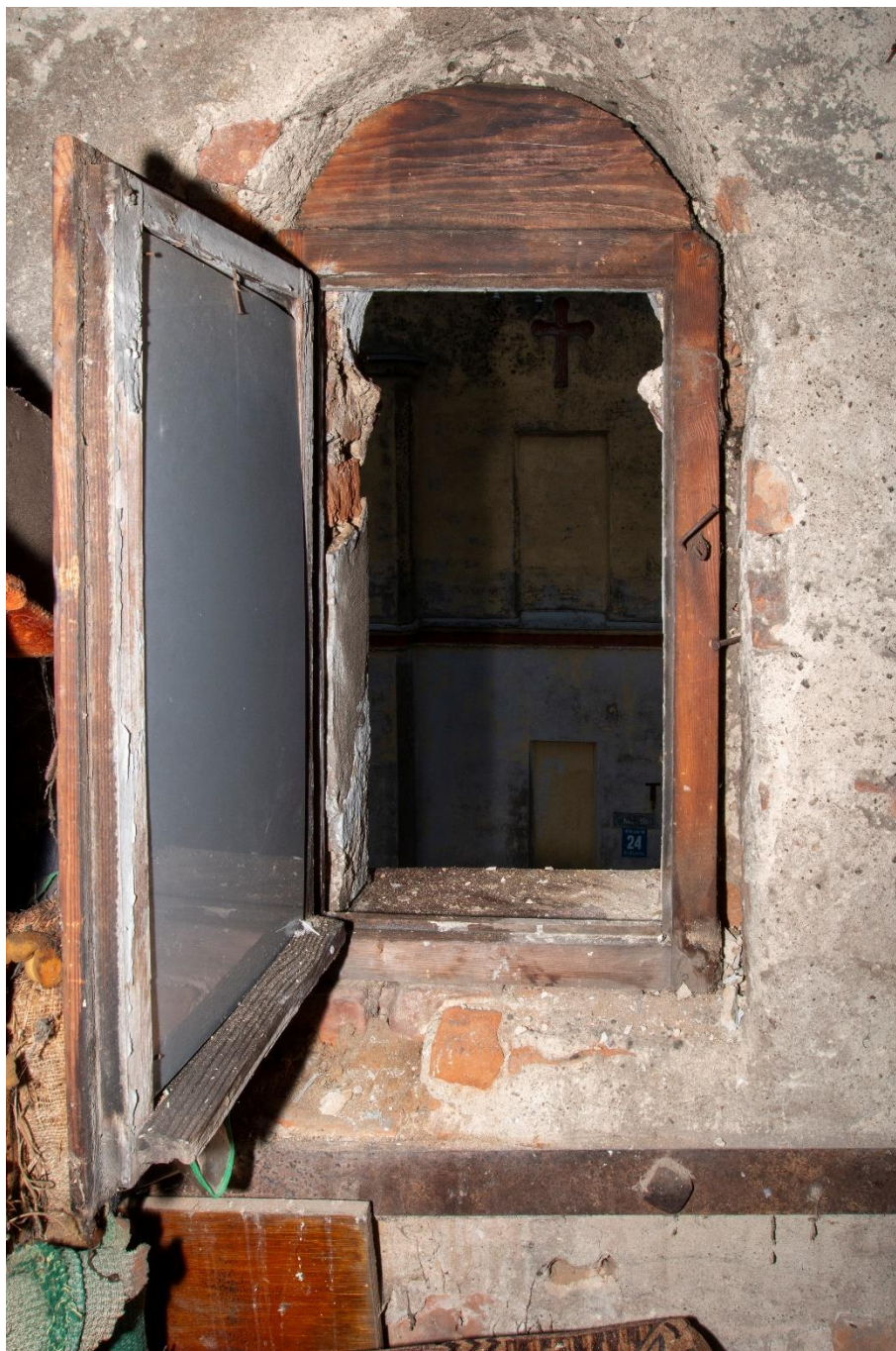
Fot. 17. Otwarte okno poddasza. Na zewnętrznej powierzchni skrzydła widoczne fragmenty łuszczącej się warstwy malarskiej w kolorze białym.
