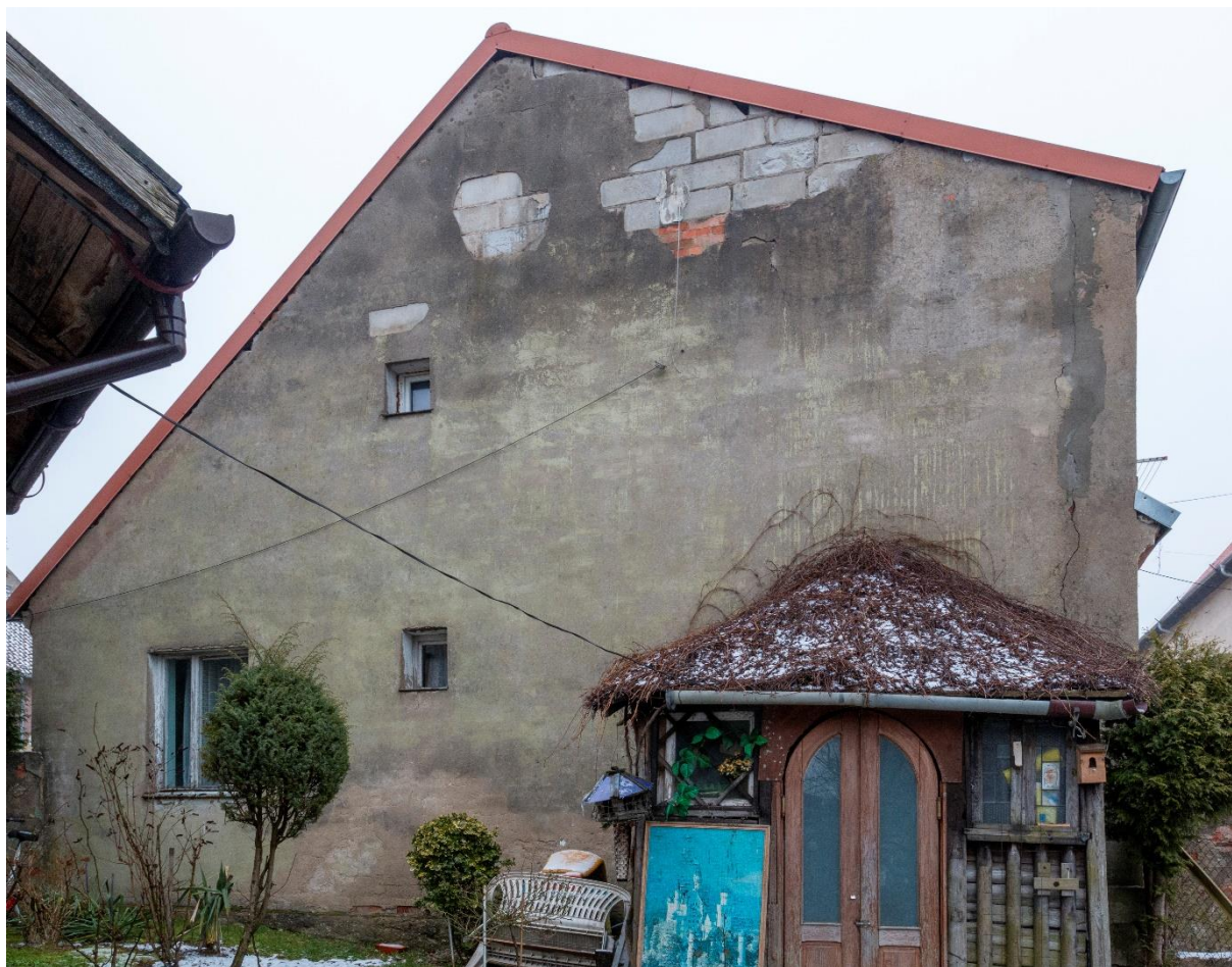
Fot. 9. Elewacja tylna, północno-zachodnia. Górna część ściany wymurowana jest z betonowych bloczków, co wskazuje na przebudowę lub naprawę górnej części muru.
