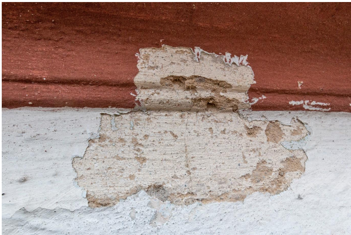
Fot. 18. Odkrywka nr 2 na elewacji bocznej, południowo-zachodniej. Przy krawędzi ściany po lewej stronie zachował się fragment pierwotnego profilu gzymsu oraz pas tynku poniżej. Wyprawa jest w znacznym stopniu zdegradowana.
