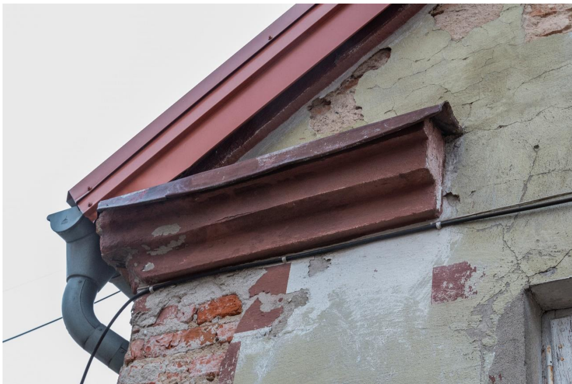
Fot. 28. Elewacja frontowa. Odcinek gzymsu przy bocznej krawędzi elewacji. Profil ma wtórną, niehistoryczną formę.
