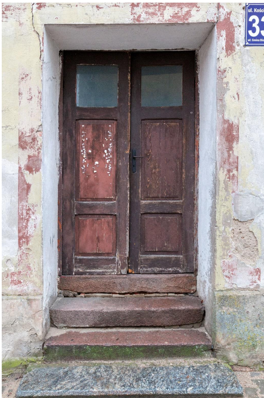
Fot. 26. Drzwi wejściowe. Podobnie jak okna najprawdopodobniej wykonane wtórnie, po wojnie. Skrzydła oraz ościeżnice drzwi wejściowych wykonywanych na początku XX w. zazwyczaj były bardziej masywne niż stolarka, którą w latach powojennych zastępowano oryginalne, zniszczone drzwi.
