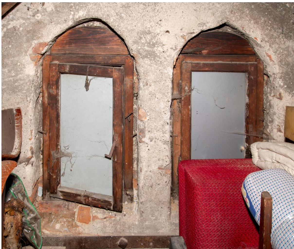
Fot. 16. Okna na poddaszu – widok od strony wnętrza. Stolarka osadzona jest za pomocą gwoździ i wkrętów. Zawiasy i klamki są współczesne, skorodowane. Górna część otworów zamkniętych łukiem jest zaślepiona. Od strony wnętrza drewno nie zostało zabezpieczone powłoką malarską. Od zewnątrz zaobserwowano złuszczone warstwy w kolorze białym.
