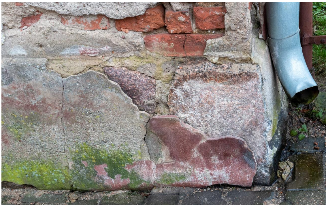
Fot. 30. Kamienny cokół, prawy narożnik elewacji frontowej. Podczas prowadzonych wspólnie remontów wążek kamienny pokryto tynkiem cementowym.
