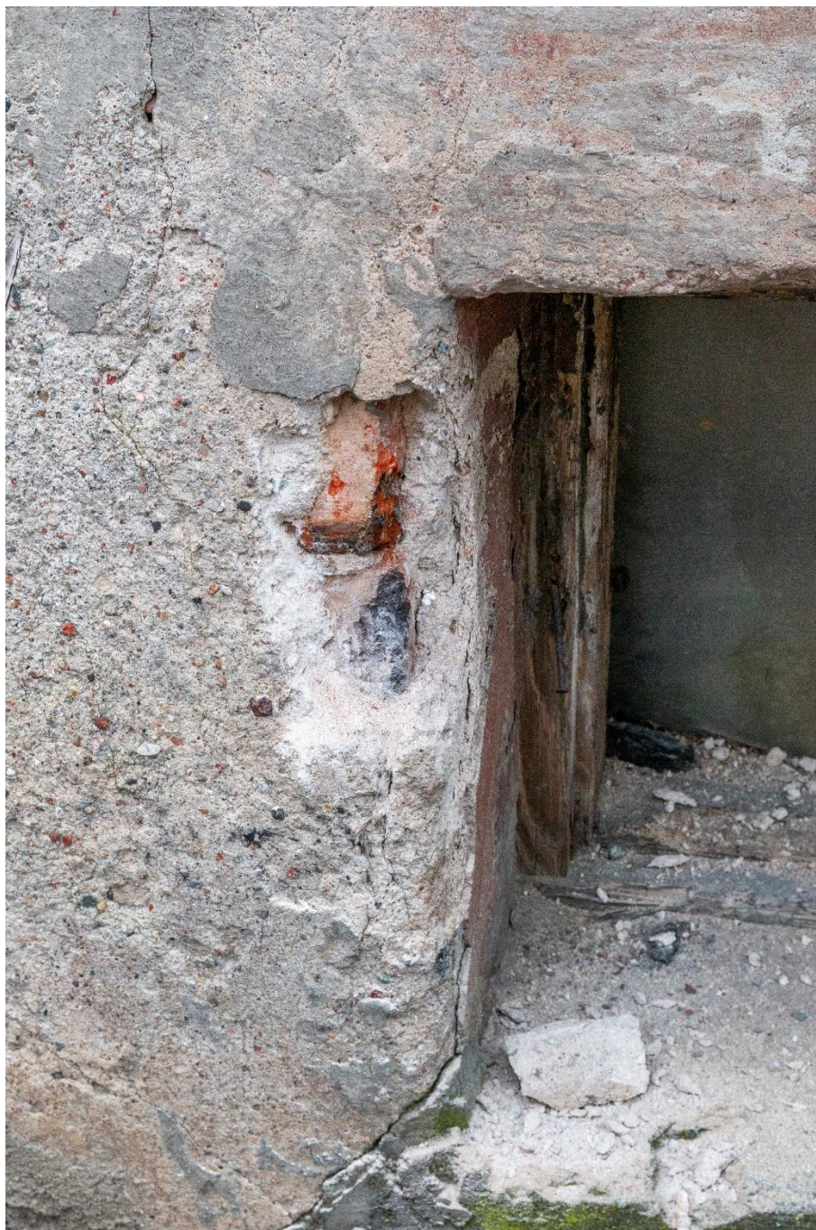
Fot. 32. Cokół po prawej stronie elewacji frontowej. Ościeża okienka piwnicznego po lewej stronie elewacji frontowej wymurowano z cegły.
