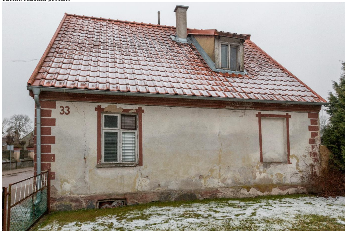
Fot. 8. Elewacja boczna, północno-wschodnia. Rysa widoczna jest w tej samej odległości od narożnika, co pionowe pęknięcie na przeciwległej ścianie, gdzie uszkodzenie znajduje się na osi krawędzi lukarny dachowej.
