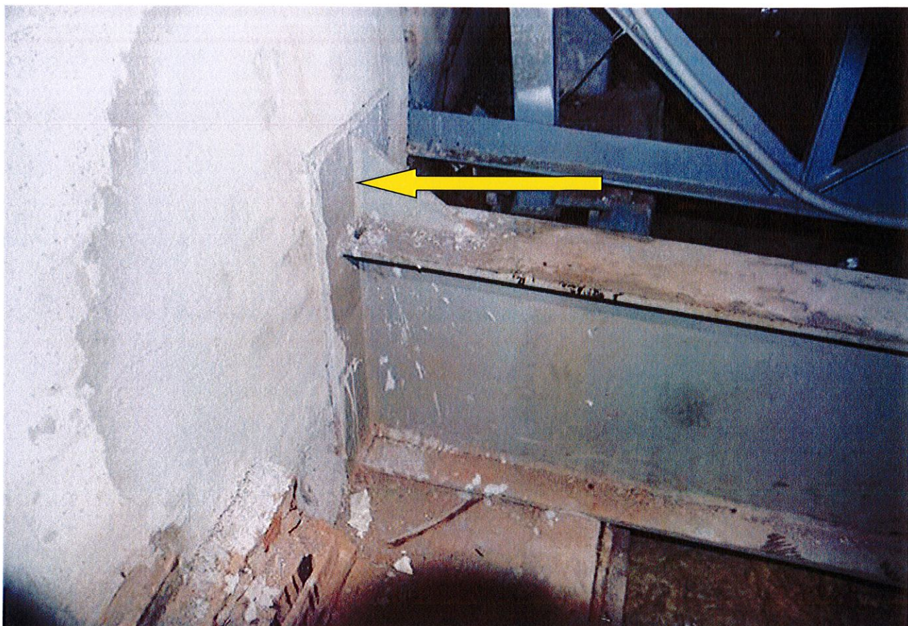
Fot. 38, 39. Poddasze nad Salą Króla Stan. Leszczyńskiego. Belka stalowa zamontowana czołowo do ściany nad stropem pomieszczenia. Poziome termiczne wydłużenie przesuwa ścianę.
