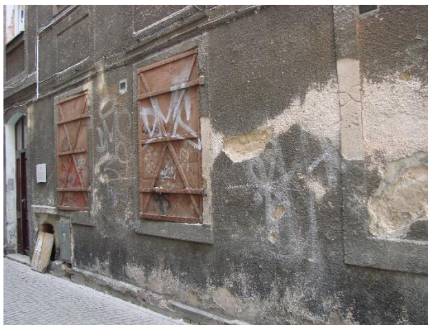
il.6 ubytki tynku w partii przyziemia elewacji bocznej
