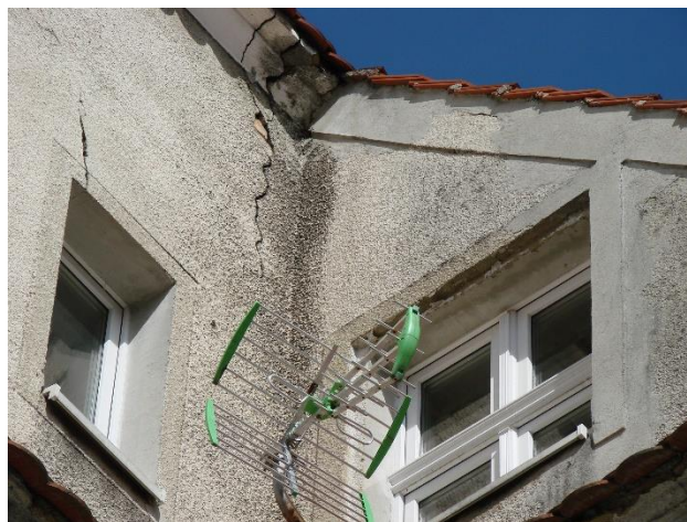
il.7 spękania i rysy na narożniku elewacji bocznej
