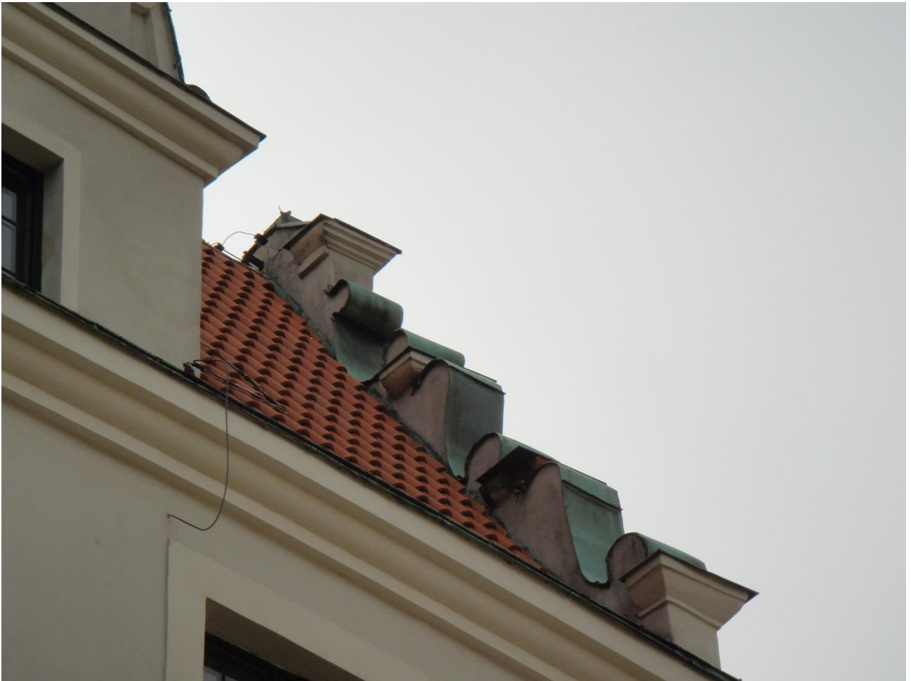
Skrzydło mennicze- widoczna dziura pod blachą
