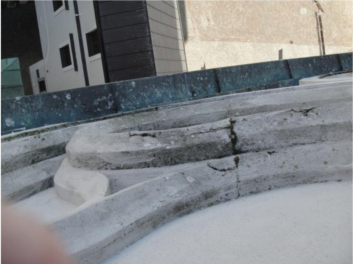
Ozdobne elementy na dachu Opery („ślimaki”)- znaczne uszkodzenia
