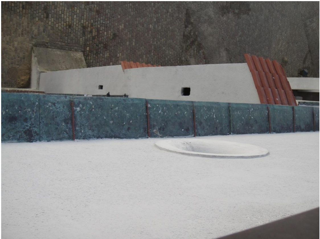
Brak osłon - skrzydło zachodnie
