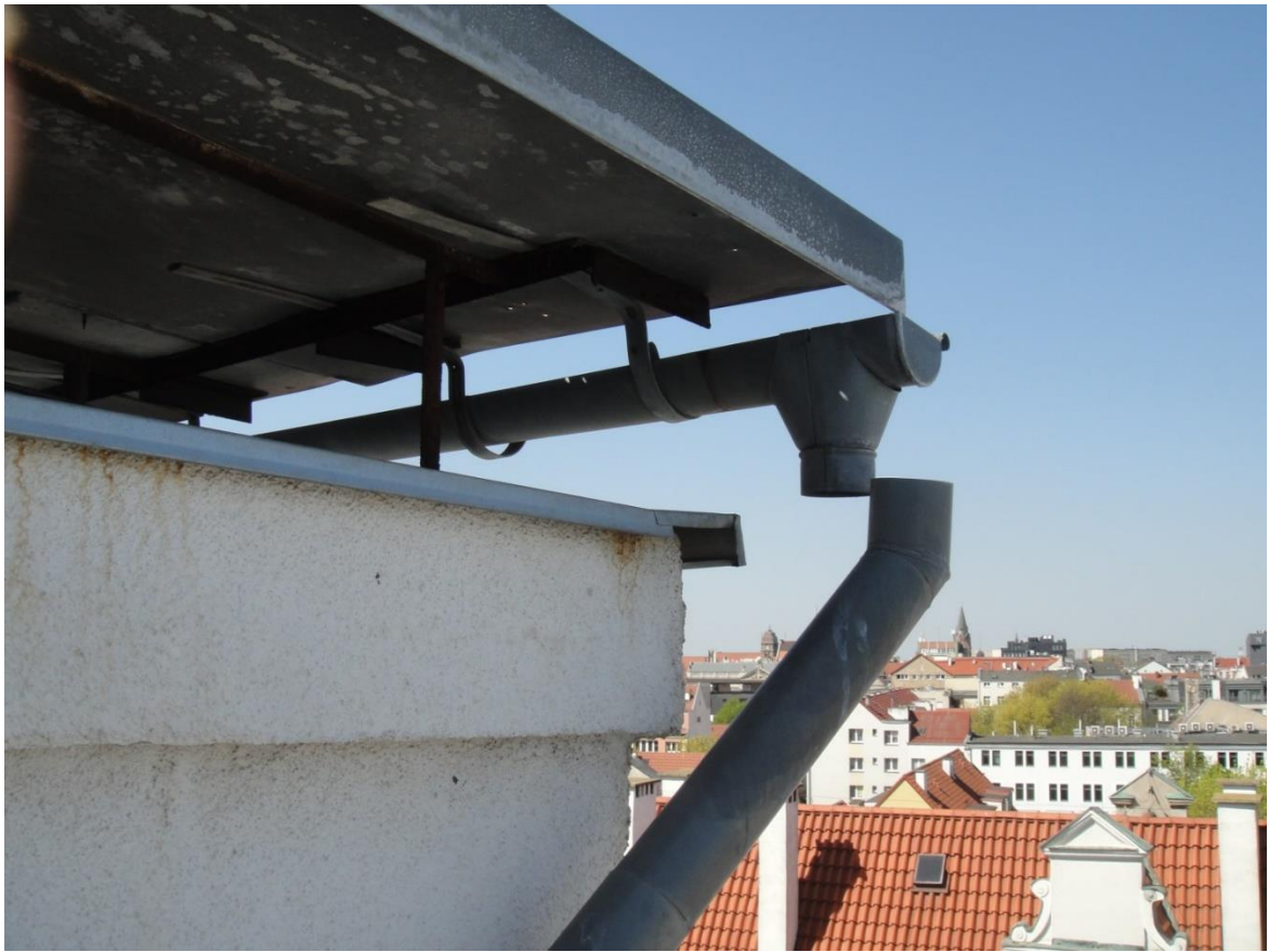
Usterka na Skrzydle zachodnim
