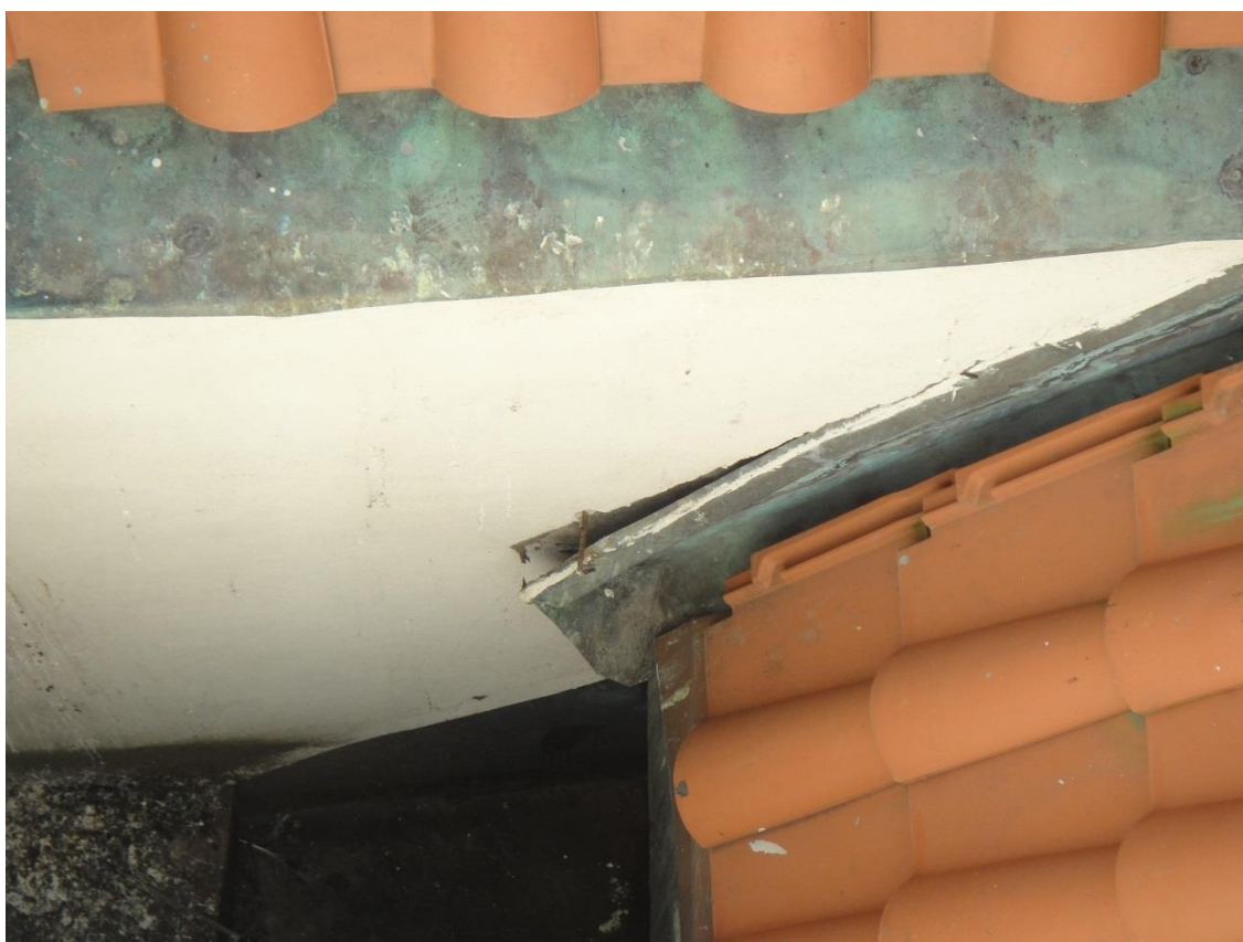
Uszkodzony Opierzenie na styku dachu i ściany
