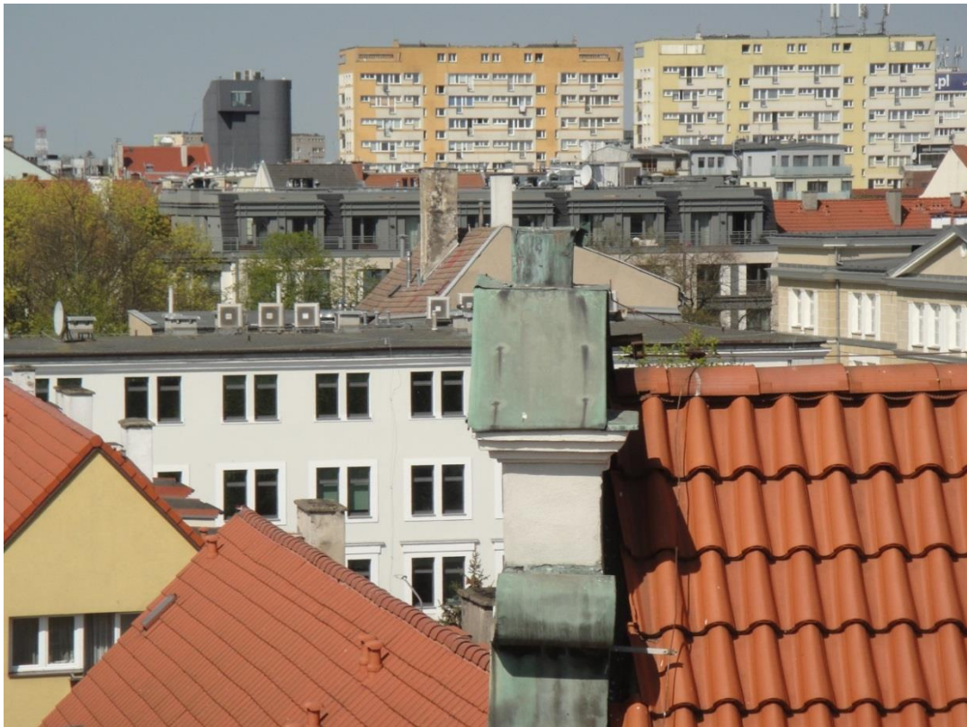
Luźna blacha na szczycie-Skrzydła Menniczego
