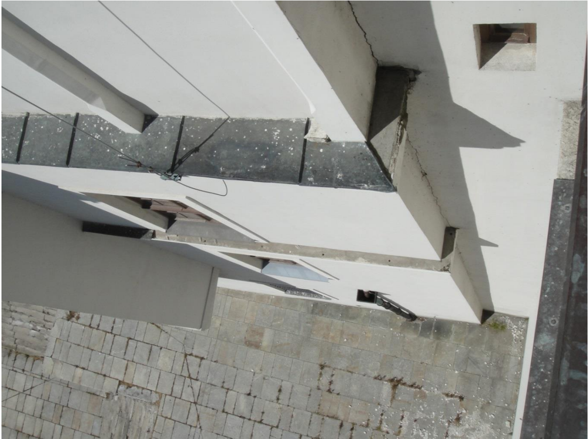
Brak parapetu na odcinku 5 metrów-ściana wschodnia
