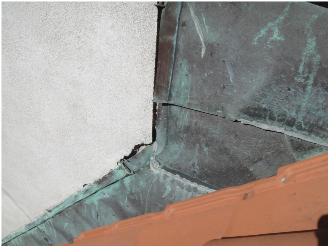
Widoczny brak elementów opierzenia z blachy
