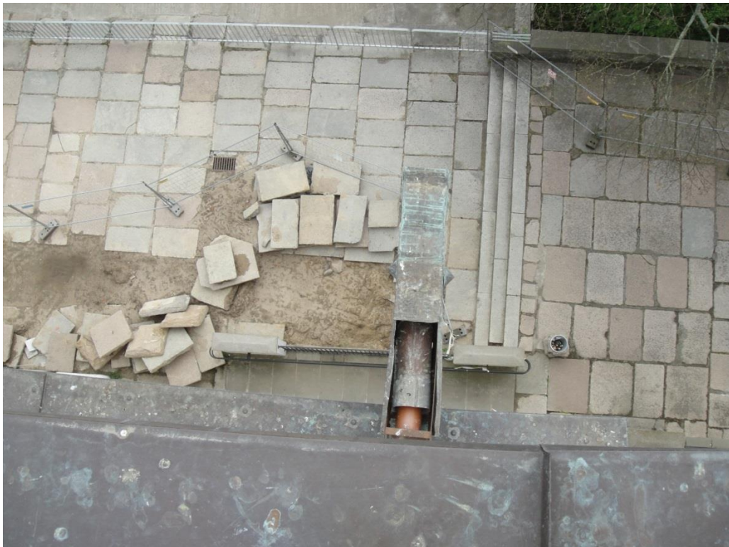
Brak pokrywy „żygacza” na ścianie wschodniej skrzydła wschodniego
