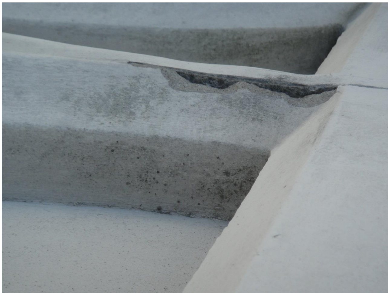
Gzyms pod „ślimakami” oraz widoczne zbrojenie (skrzydło południowe)
