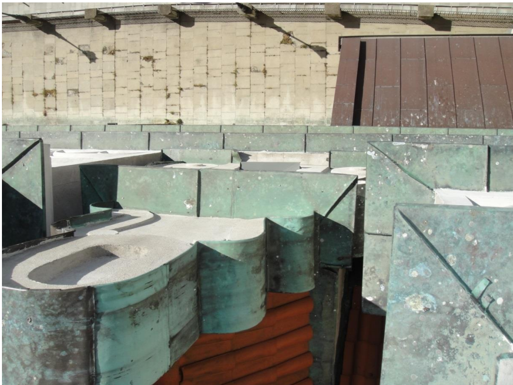
Brak parapetu-ściana południowa skrzydła menniczego
