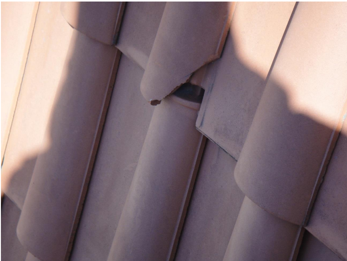
Złamana dachówka skrzydła mennisznego
