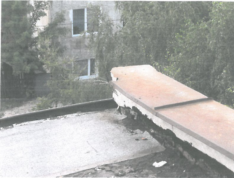
Widoczna korozja rynien i pasa podrynnowego
