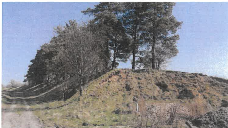
Piaszczyzna - zniszczony nasyp pomiędzy wiaduktem a dawną stacją
