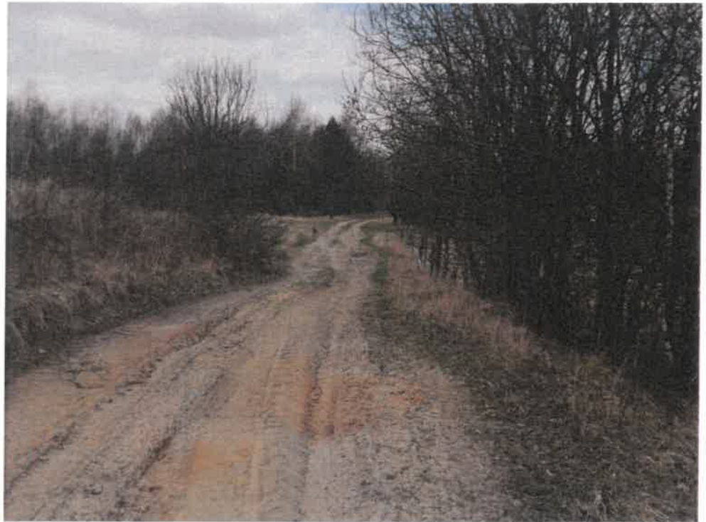
Dolsko - Piaszczyzna - piaszczyste, rozjeżdżone przez ciągniki rolnicze drogi polne (3,8 km), po których prowadzi obecnie objazd trasy - konieczne prace, związane z poprawą nawierzchni.
