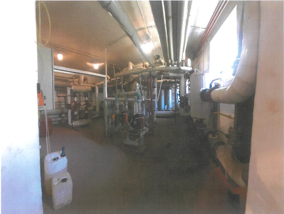
Fot. nr 3 węzeł cieplny
