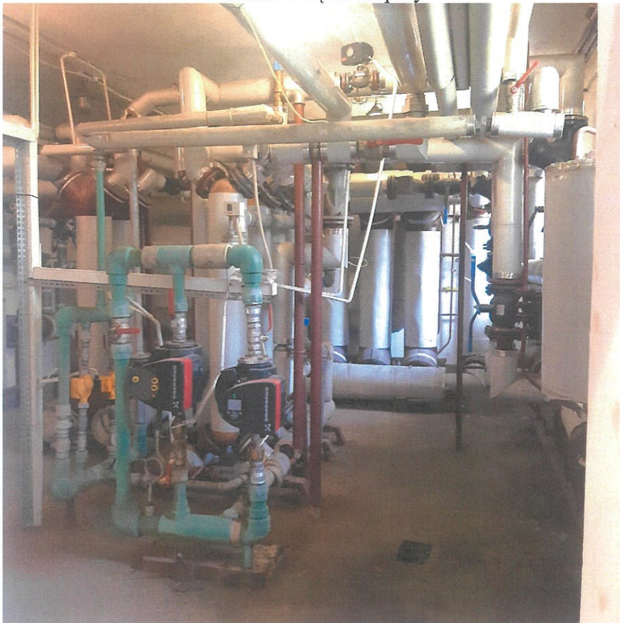
Fot nr 4 węzeł cieplny
