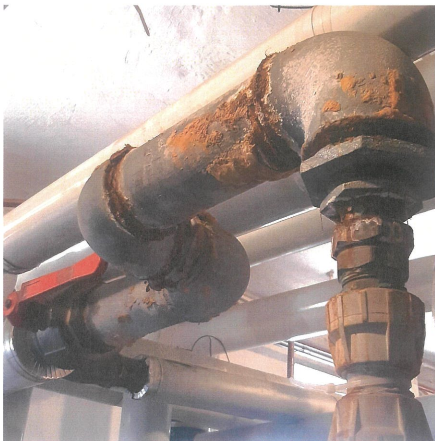
Fot nr 8 węzeł cieplny
