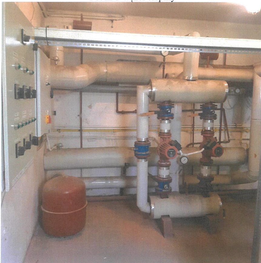
Fot nr 5 węzeł cieplny
