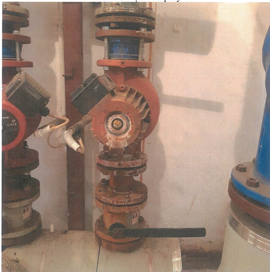
Fot nr 6 węzeł cieplny
