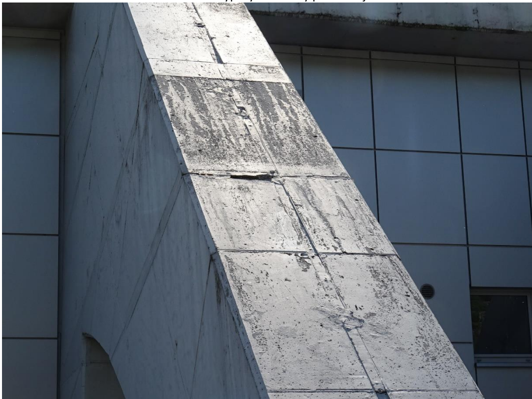
Fot. 6. Nieprawidłowa jakość betonu przypory
