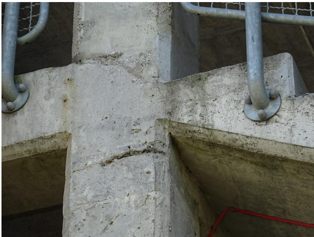
Fot. 7. Nieprawidłowa jakość betonu schodów ewakuacyjnych
