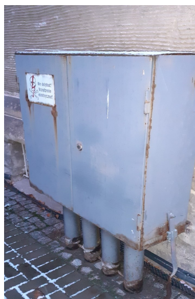
ROZDZIELNIA PRZY ELEWACJI POŁNIOWEJ A
